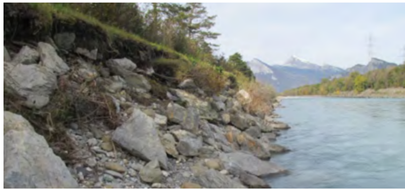
Foto 1: Zustand Uferbereich mit fehlendem Uferschutz aufgrund der sich weiter eintiefenden Rheinsohle.
